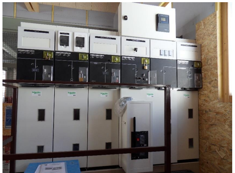
Figure 32 : Armoire électrique Pièce jointe 104
