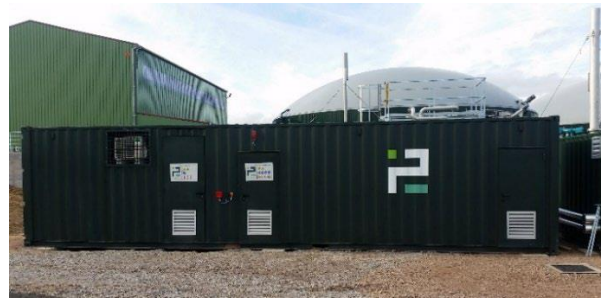
Figure 9 : Container d'épuration du biogaz
