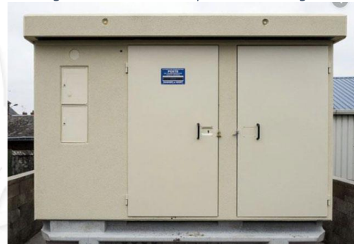
Figure 11 : Poste de transformateur électrique
