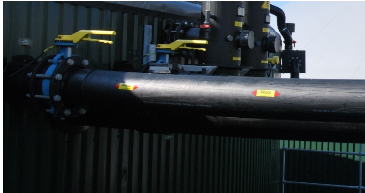
CANALISATION DE TRANSPORT DE BIOGAZ
