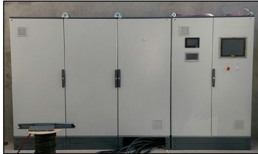
EXEMPLE DE BOUTON POUSSOIR D'ARRÊT D'URGENCE SUR ARMOIRE ELECTRIQUE
