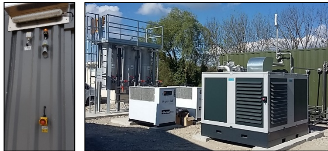
EXEMPLE DE BOUTON POUSSOIR D'ARRÊT D'URGENCE SUR LE CONTAINER D'EPURATION ACCOMPAGNE DE L'EQUIPEMENT DE L'ALARME LUMINEUSE ET SONORE
