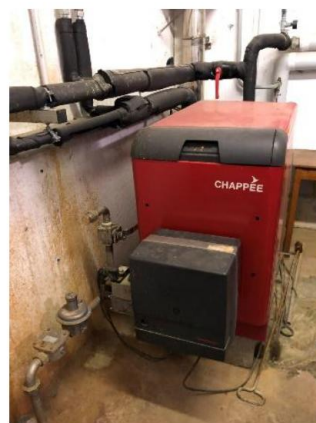
Chaudière biogaz 50 kW
