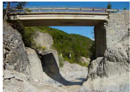
Photo 2.23 : Détecteur de lave torrentielle
