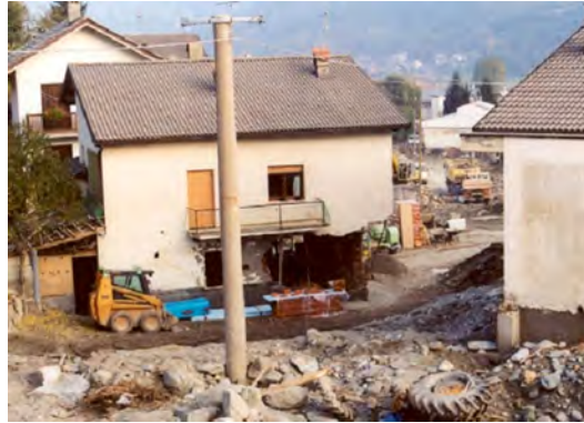
Photo 6.8 : Val d'Aoste 2000, endommagement d'un angle
