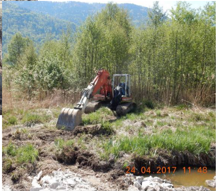
Détérioration et remblai en zone humide
