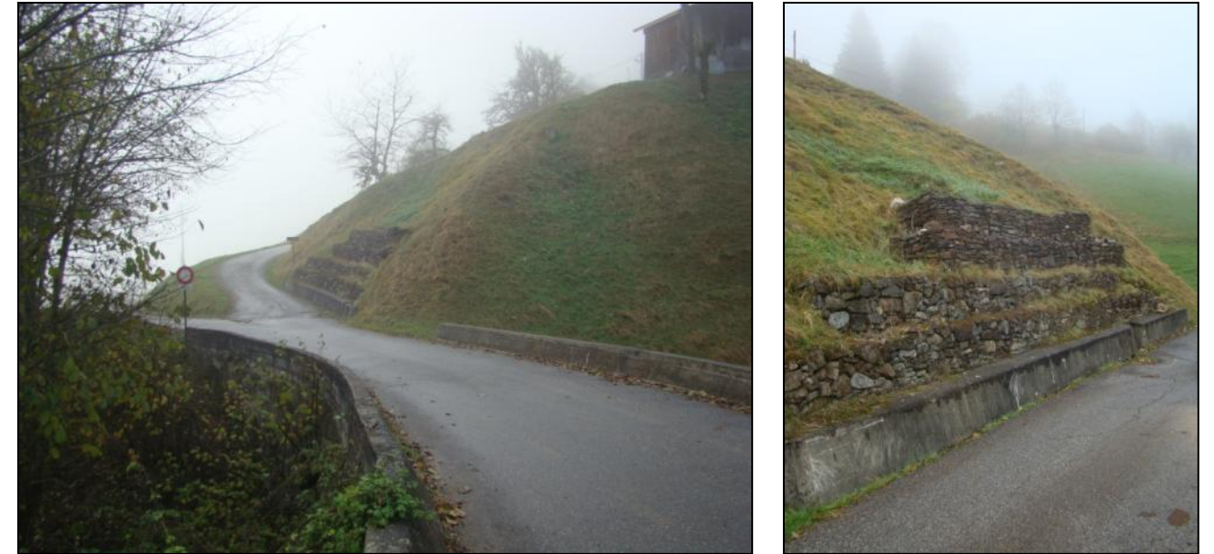
Figure 16 : Fissuration et affaissement de la RD 218E au niveau de la limite communale [Source : IMS RN ]
