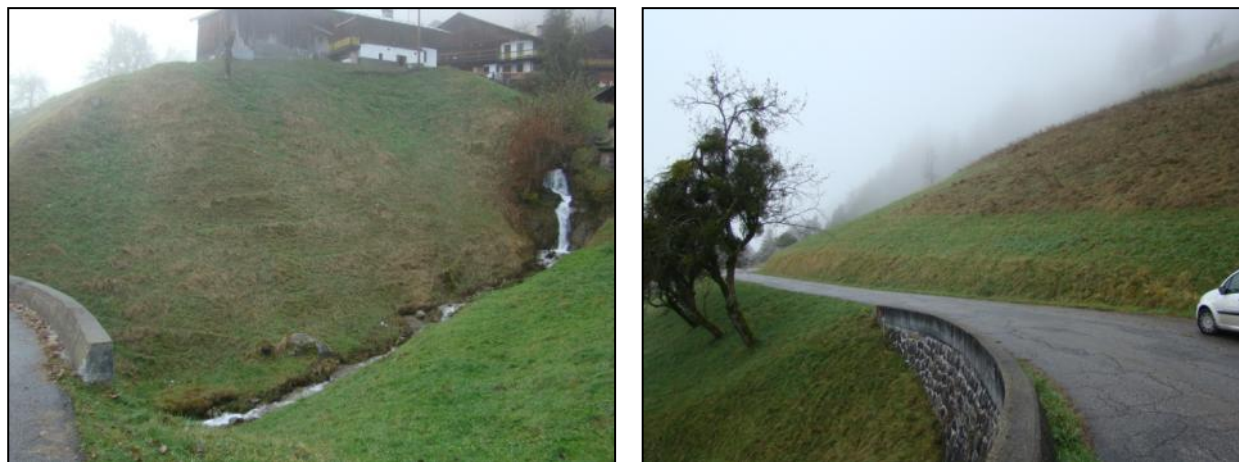
Figure 15 : Rides (photo de gauche) et désordres sur chaussée et végétation (photo de droite) dans les talwegs encadrant le hameau des Côtes [Source : IMS RN ]
