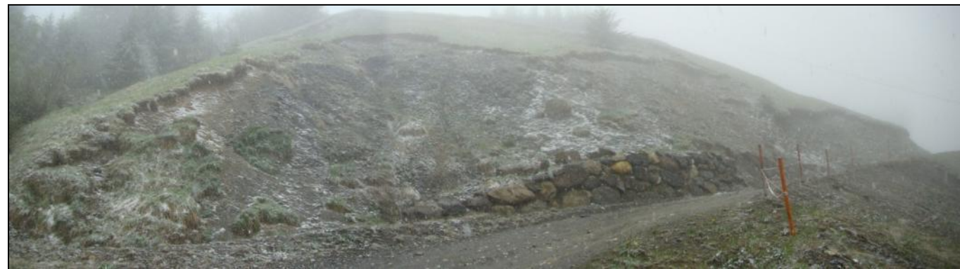
Figure 26 : Glissement de terrain et confortement par enrochements le long de la route menant au Charbet [Source : IMS RN ]
