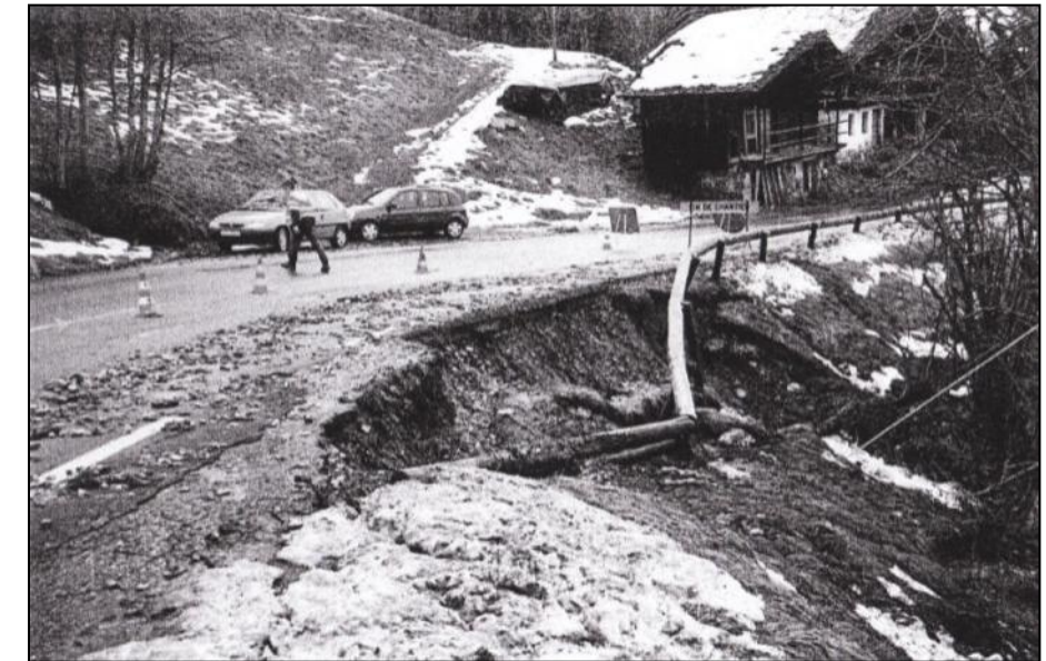
Figure 2 : Glissement de l'accotement aval de la RD 218b (au PR 9.100) le 13 janvier 2004 [Source : SAGE INGENIERIE / CG 73]
