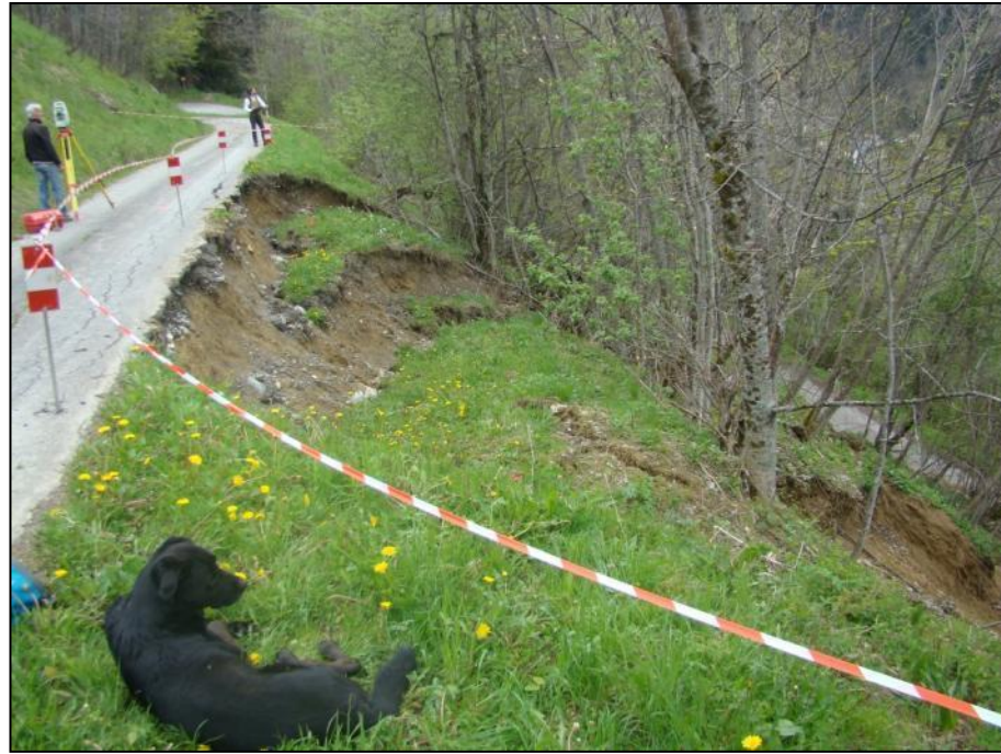
Figure 3 : Glissement de l'accotement aval de la route entre Belleville et Lécheru (photo prise le 12 mai 2014) [Source : IMS RN ]
