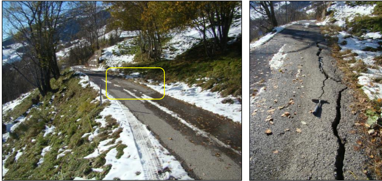
Figure 33 : Fissuration de la chaussée à Lécheru sur des terrains très pentus présentant des déformations topographiques et des désordres sur la végétation (arbres « en pipe »). A noter la présence d'un gabion au niveau du virage avant le talweg [Source : IMS RN ]
