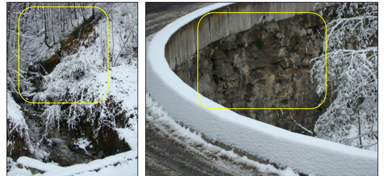
Figure 23 : Loupe de glissement et arbre « en pipe » (photo de gauche) et mur de soutènement aval endommagé (photo de droite) au niveau du talweg du Charbet [Source : IMS RN ]
