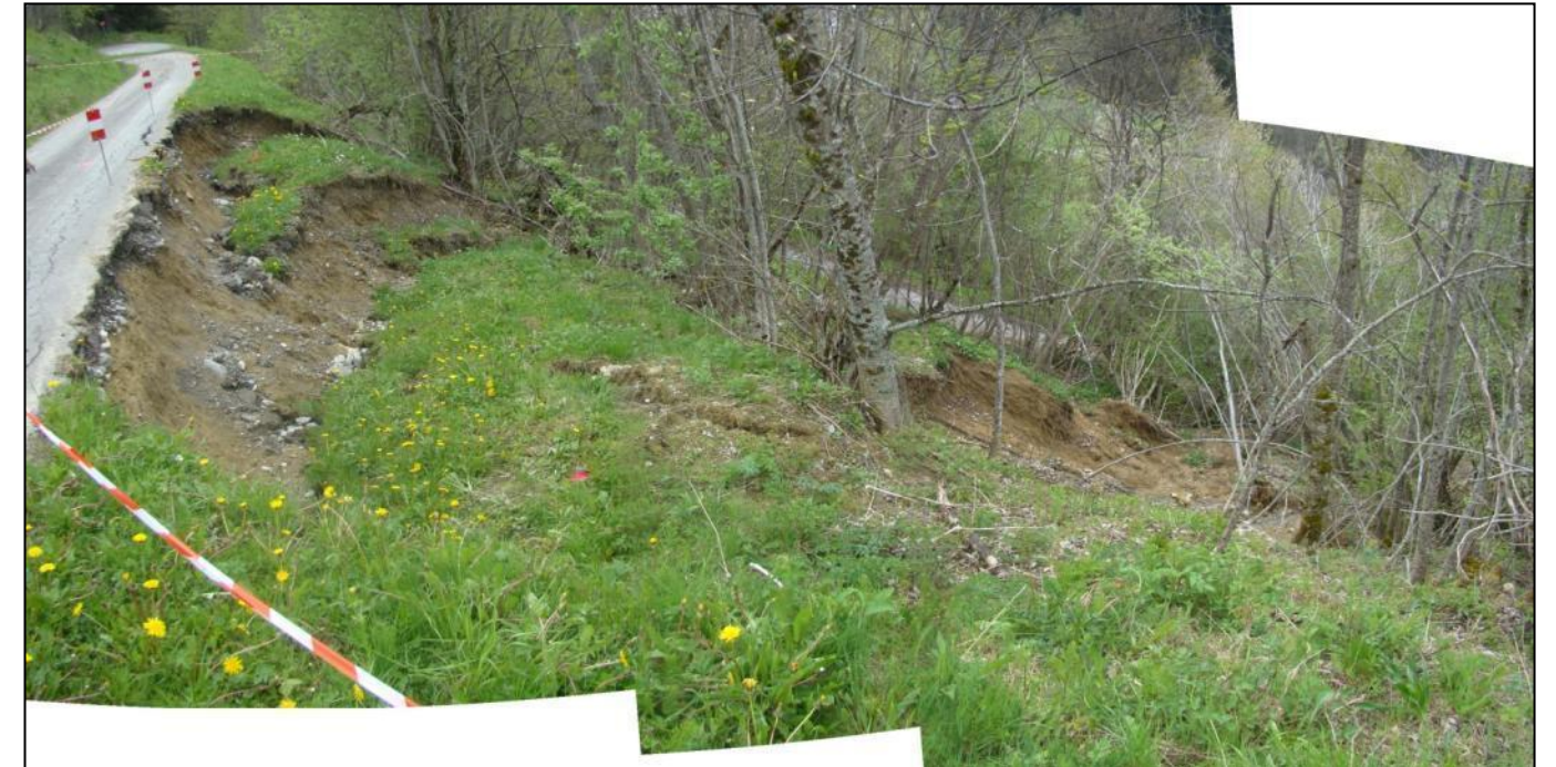
Figure 27 : Glissement de terrain sur la route entre Belleville et Lécheru [Source : IMS RN ]
