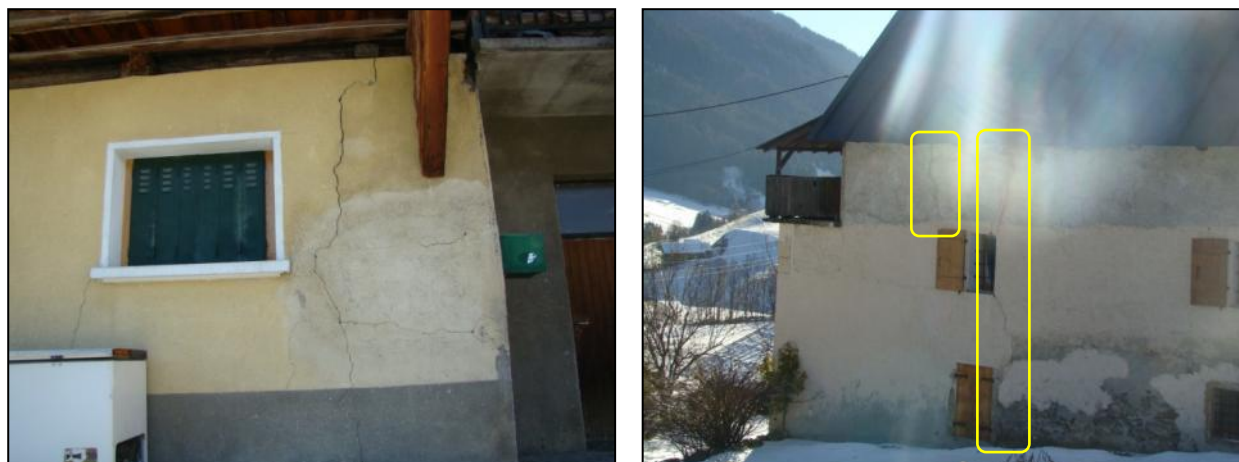
Figure 34 : Fissuration du bâti dans le hameau de Belleville [Source : IMS RN ]
