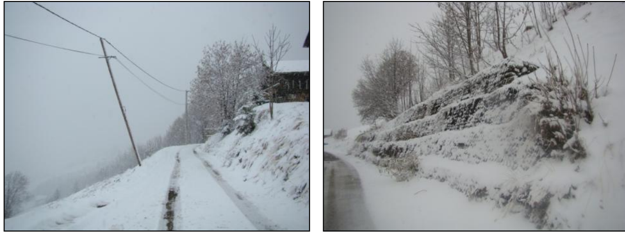
Figure 24 : Poteau incliné (photo de gauche) et gabions (photo de droite) le long de la route en amont des Prés [Source : IMS RN ]
