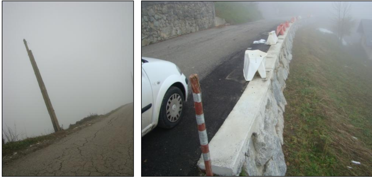
Figure 17 : Poteau incliné et fissuration de la chaussée (photo de gauche) et confortement par enrochements bétonnés (photo de droite) le long de la route menant aux Evettes [Source : IMS RN ]
