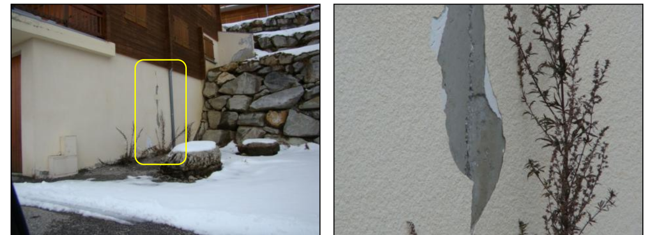
Figure 9 : Fissuration de bâtiment et enrochements dans la station des Saisie [Source : IMS RN ]
