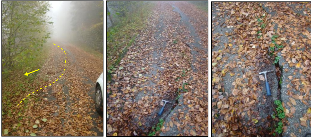
Figure 14 : Fissuration et affaissement de la RD 218E au niveau de la limite communale [Source : IMS RN ]
