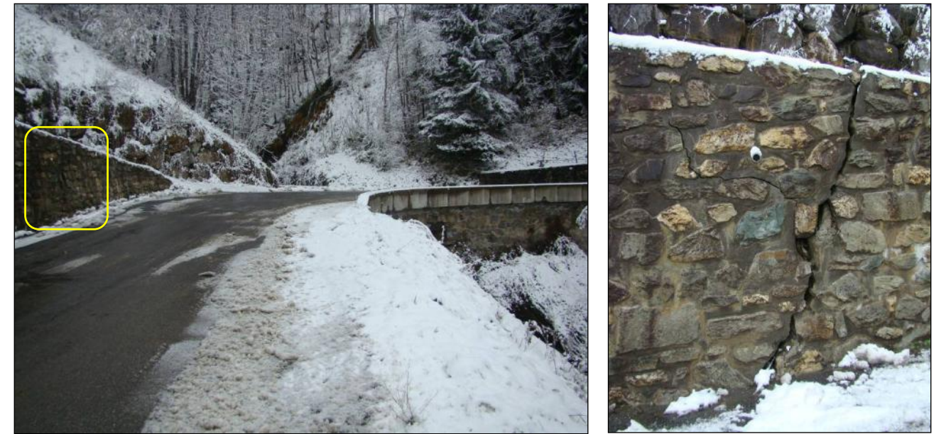
Figure 22 : Dommages (fissure ouverte et décalage) sur le mur de soutènement amont au niveau du talweg du Charbet [Source : IMS RN ]
