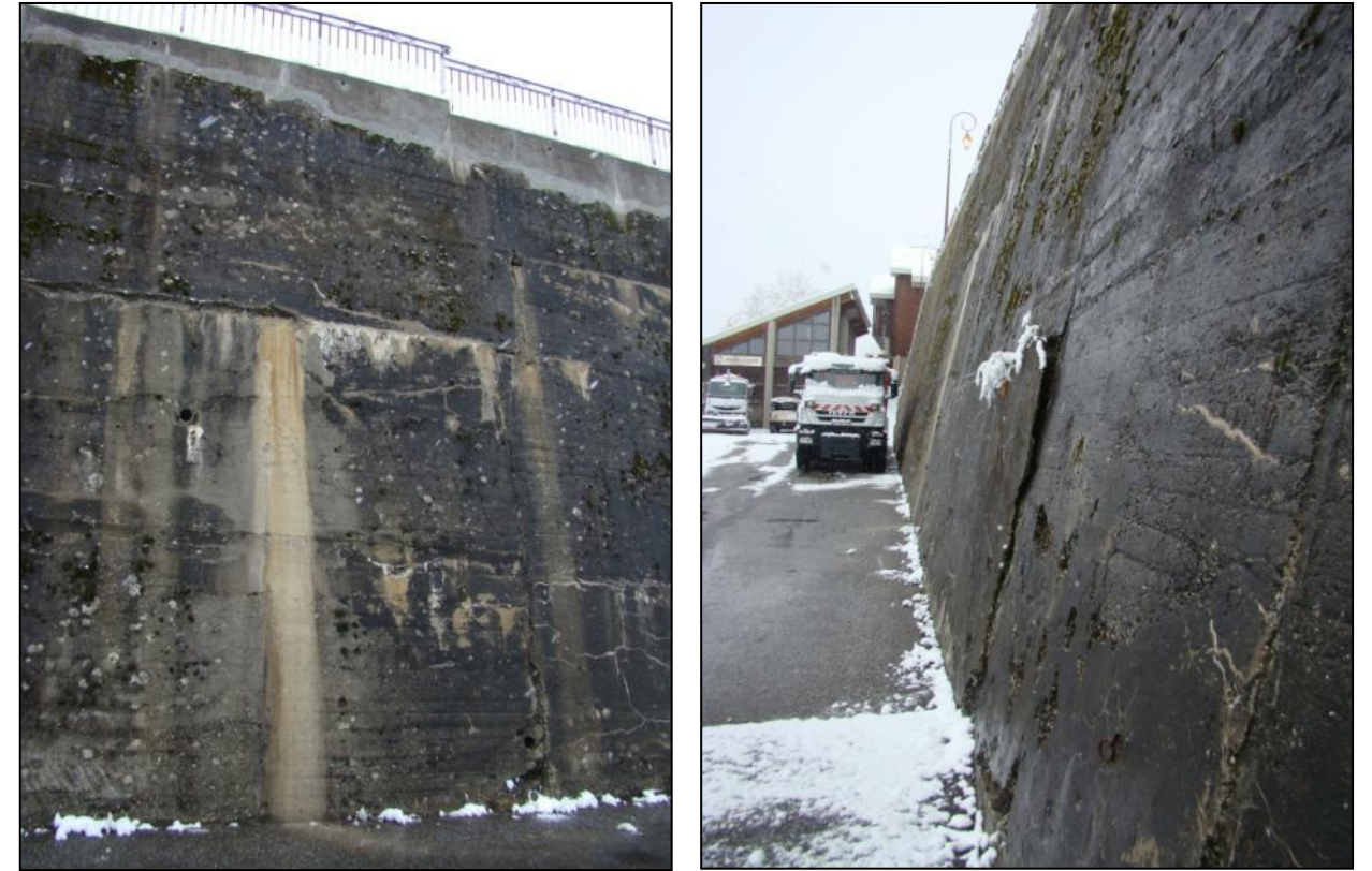
Figure 19 : Suintement important hors des drains (photo de gauche) et dommages (photo de droite) sur le mur de confortement sous la RD 70 en aval du cimetière [Source : IMS RN ]
