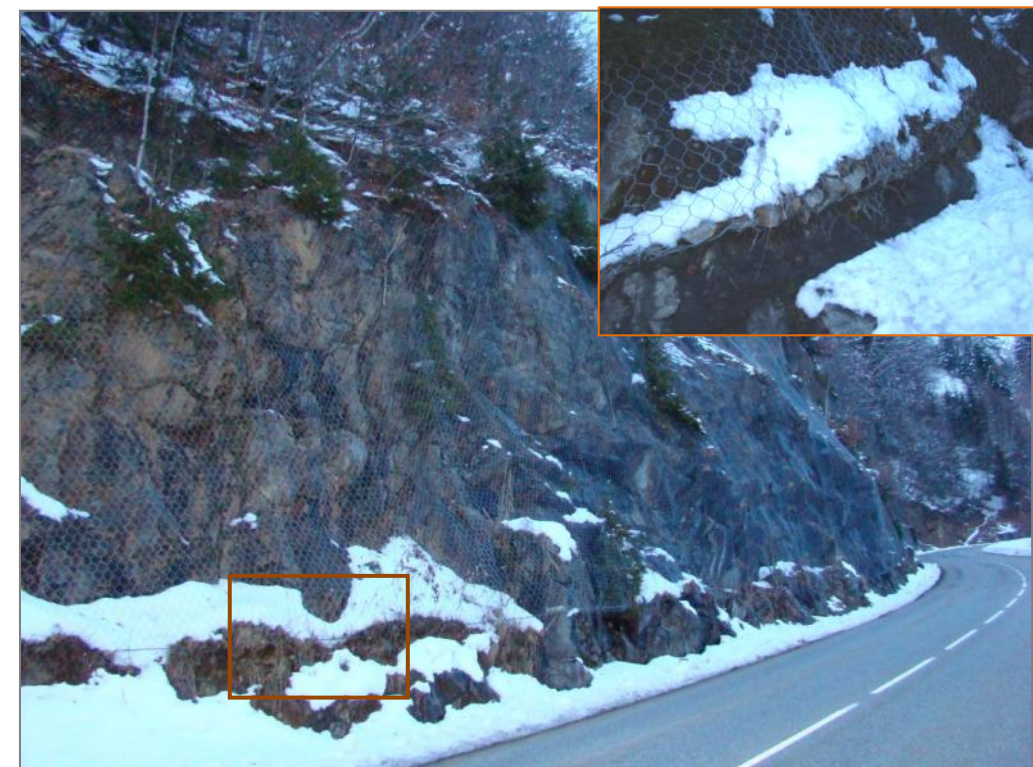
Figure 3 : Grillage plaqué sur un escarpement le long de la RD 18b [Source : IMS RN ]
