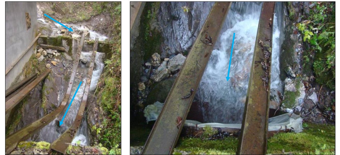
Figure 12 : Passage busé sous-dimensionné du Nant de Chosal à l'arrière de la scierie [Source : IMS RN ]
