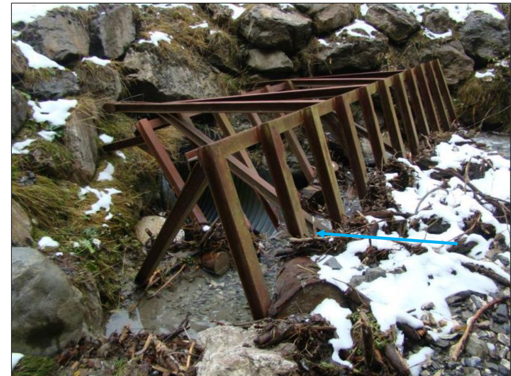
Figure 13 : Dispositif anti-embâcle sur le Nant du Chosal, au niveau du passage busé sous la piste de ski [Source : IMS RN ]
