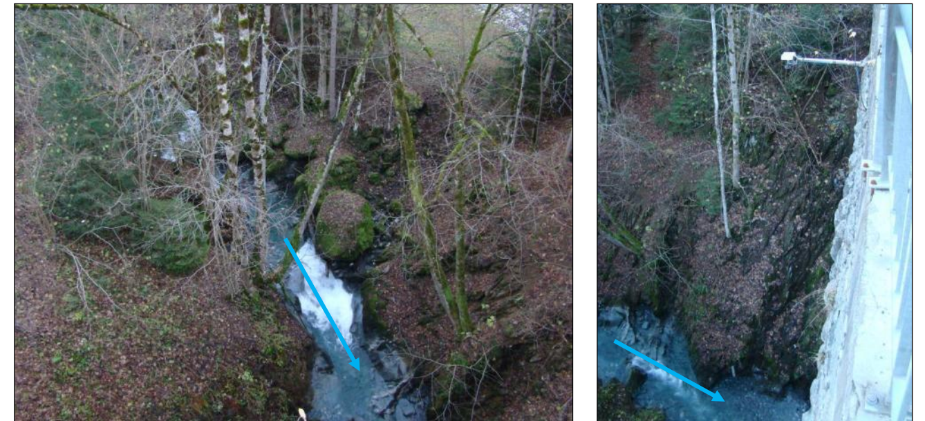
Figure 18 : Torrent du Dorinet encaissé au niveau du pont de la RD 70 (équipé d'un capteur de hauteur d'eau) [Source : IMS RN ]
