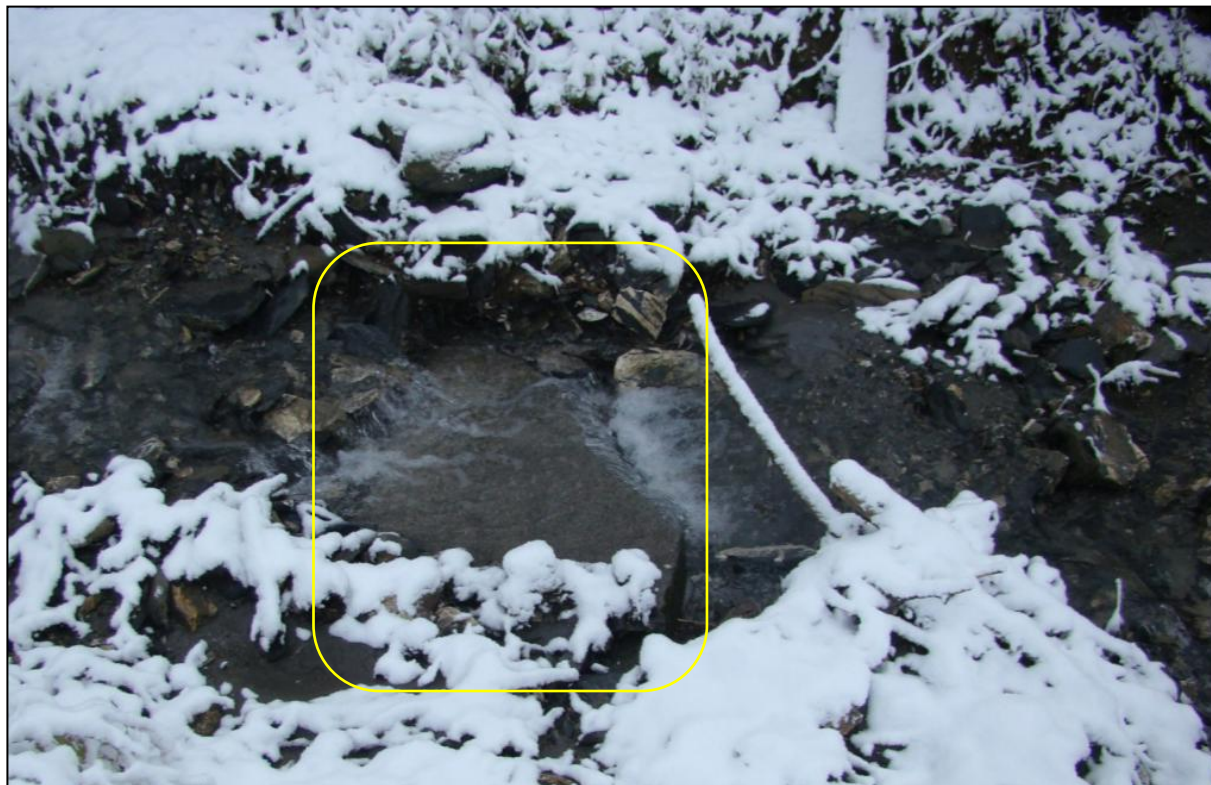
Figure 21 : Seuil en béton construit dans le torrent d'annuit en 1966, complètement recouvert [Source : IMS RN ]
