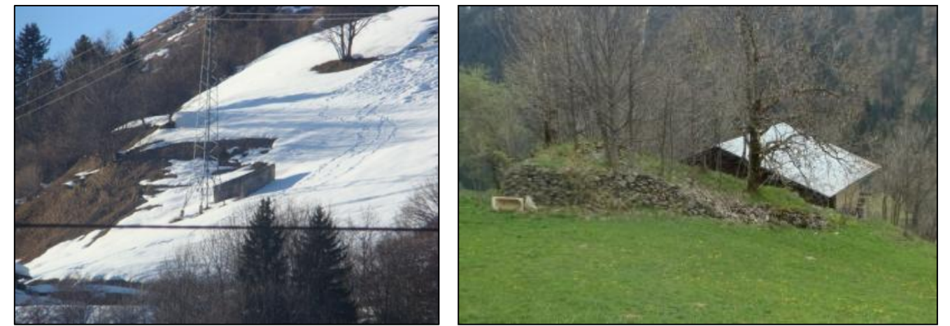
Figure 1 : Etrave en béton (à gauche) et en maçonnerie + terre (à droite) [Source : IMS RN ]
