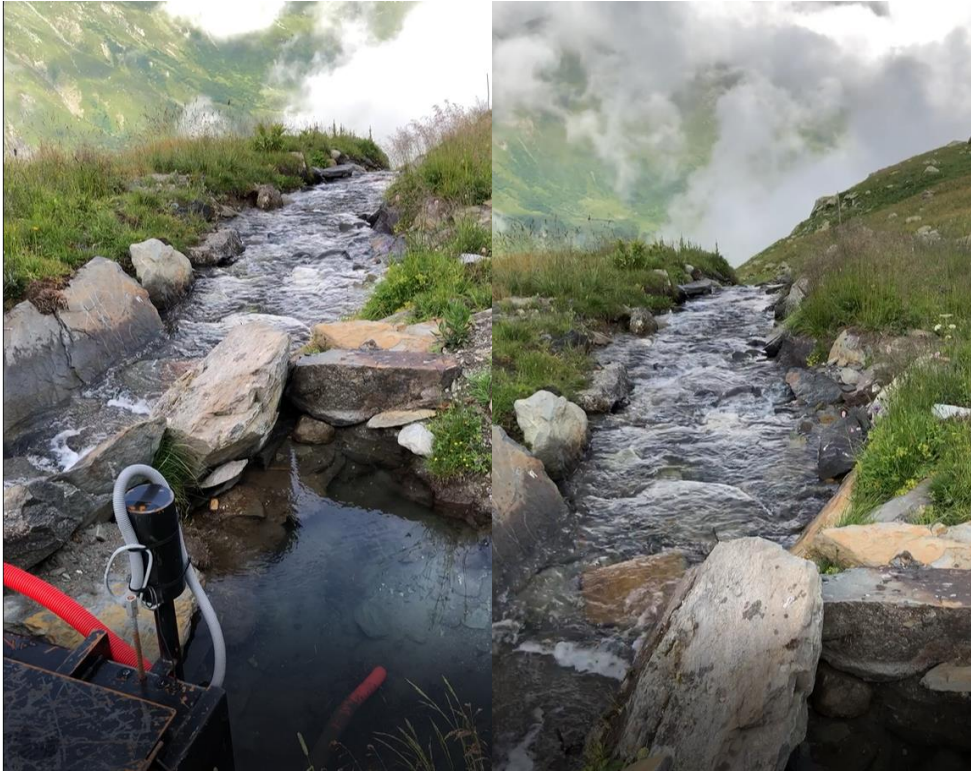
Photo 2 : vue sur la partie aval de la prise d'eau de la pico-centrale
