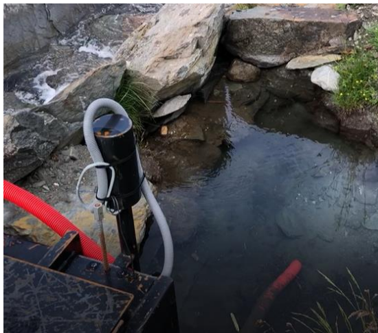
Dessableur de l'ouvrage de captage
