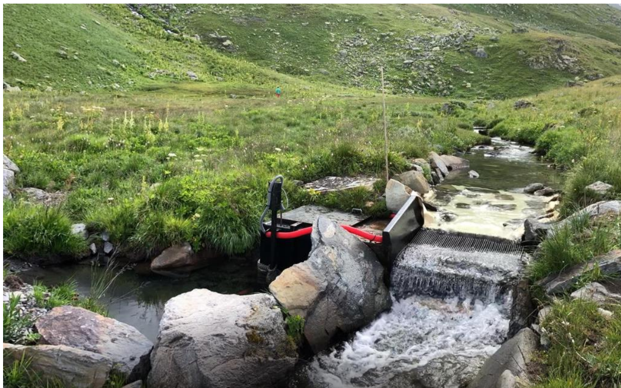
Photo 1 : vue sur la partie amont de la prise d'eau de la pico-centrale
