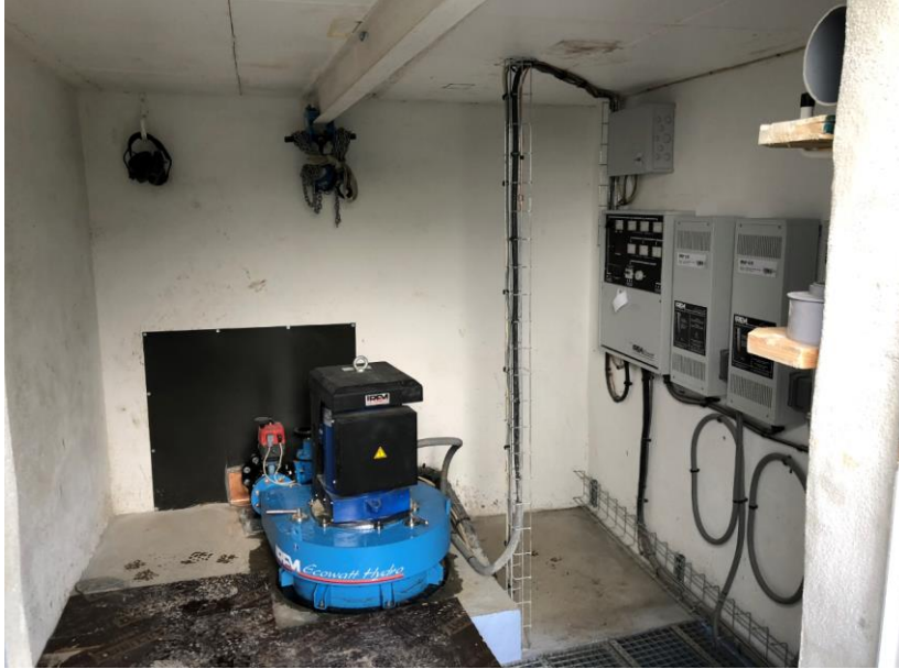
Local de la Pico-centrale
